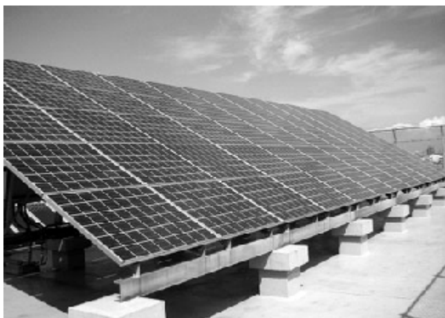
写真上：市川市勤労福祉センター屋上の設置例 （最大出力10KWの太陽光発電システムを60枚のパネルが構成）
