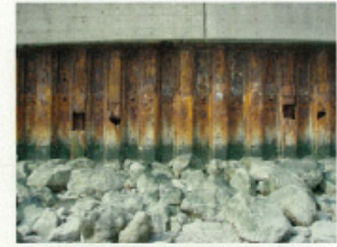
腐食による穴
