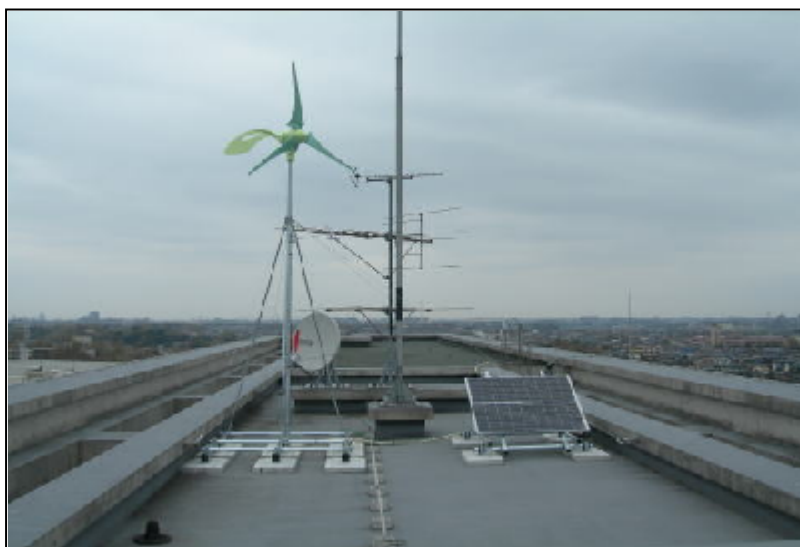
写真：大学に設置されている風力発電と太陽光発電
