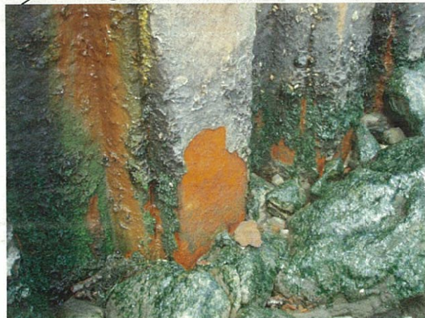
⑧鋼矢板剥離
