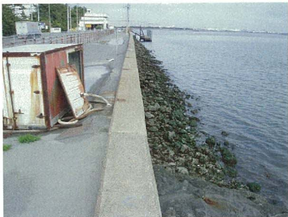
③護岸の傾き (東側)
