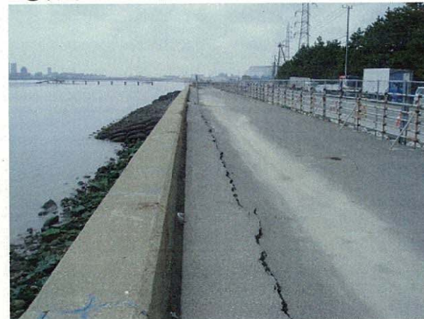
②舗装版破壊
