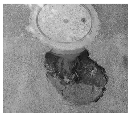
▲下水道管破損による道路陥没状況
