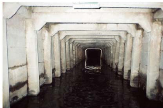
■ 老朽化が進む柵渠
