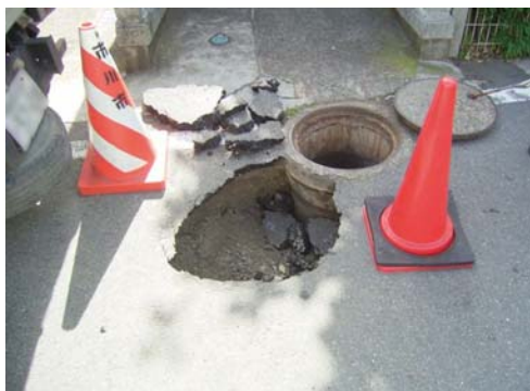
■ 下水管の老朽化に伴う道路陥没状況
