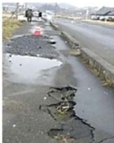
無対策箇所（被害大）
