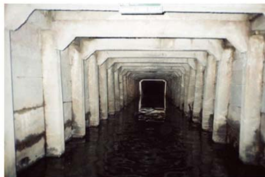
■ 老朽化が進む柵渠
