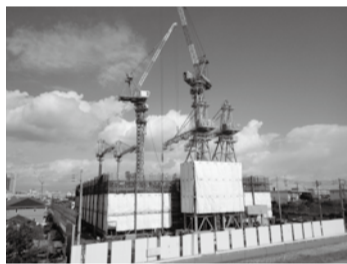
▲雨水を効率的に排水し、浸水を防ぐ大和田ポンプ場(建設中)
