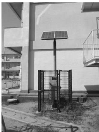
中山小学校の太陽光発電設備
