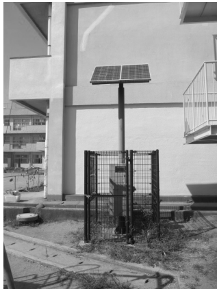
中山小学校の太陽光発電設備
