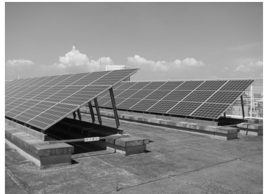
妙典中学校の太陽光発電設備
