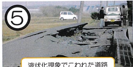
液状化現象でこわれた道路
