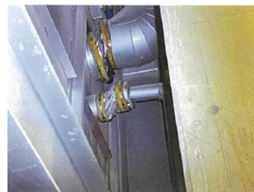
管寄せエキスパンションの破損
