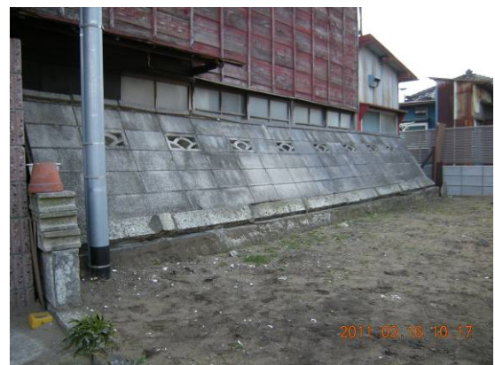
隣地に転倒したブロック塀
