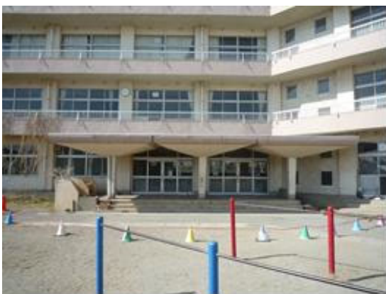
曽谷小キャノピーの破損
