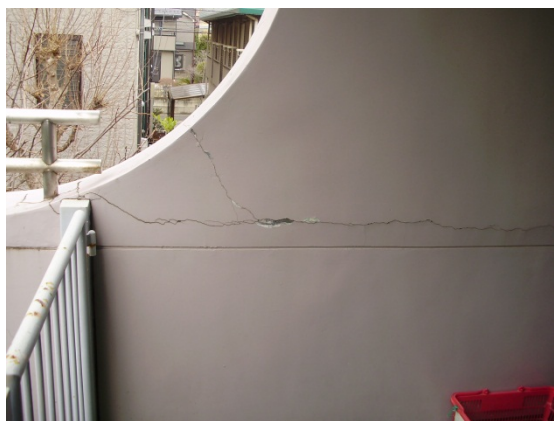
塩焼保育園の壁面クラック
