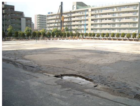
塩浜中の液状化の様子
