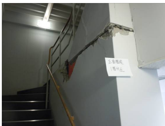
情報プラザ階段室の亀裂
