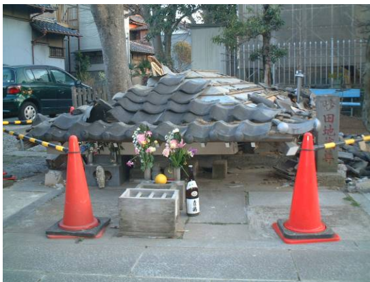
昭和18年建立の妙田地蔵尊囲い屋根が崩落
