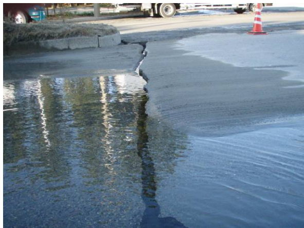
道路に生じたクラックと漏水
