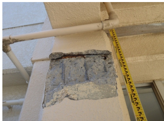
北方小渡り廊下の露出した梁受け部
