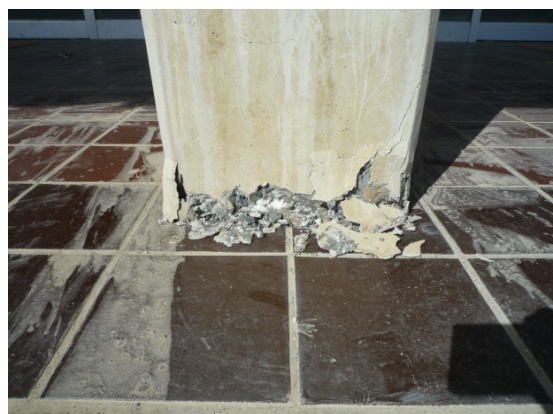
破損した曽谷小キャノピーの基底部
