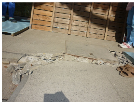
塩浜保育園の基礎亀裂
