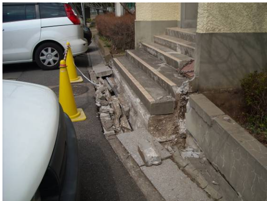
塩浜小の階段下に生じた段差
