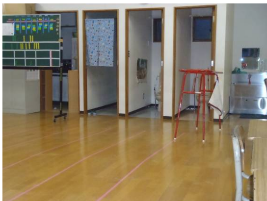
建物の不等沈下による床の傾斜（塩焼小）
