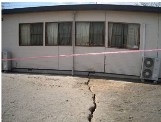
建物直下にクラックが生じた（塩焼小）
