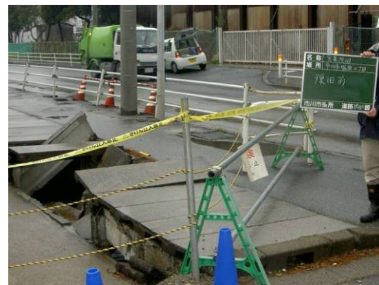
柵渠破損（塩浜2丁目）
