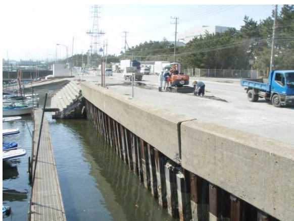
市川漁港の護岸の傾斜
