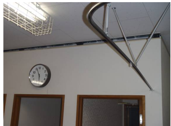
天井と壁の間の隙間（塩焼小）
