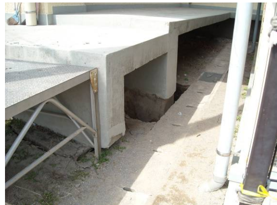
塩浜小の地盤沈下
