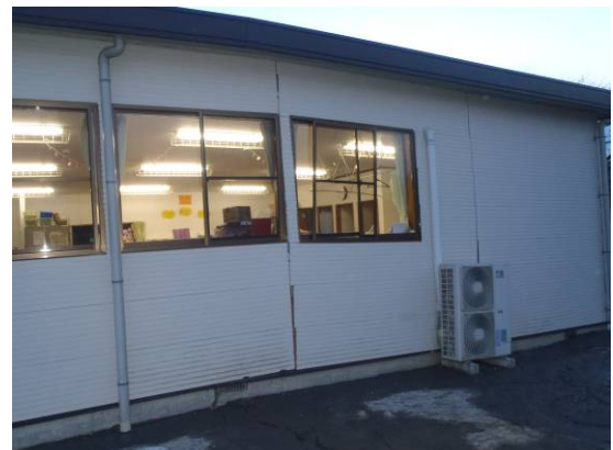
液状化により基礎が割れた（塩焼小）
