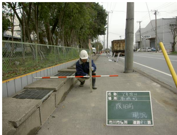
液状化により生じた道路の段差
