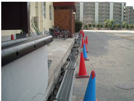
塩浜中の排水溝の被害
