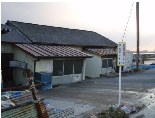
液状化により大きく傾斜した漁業施設
