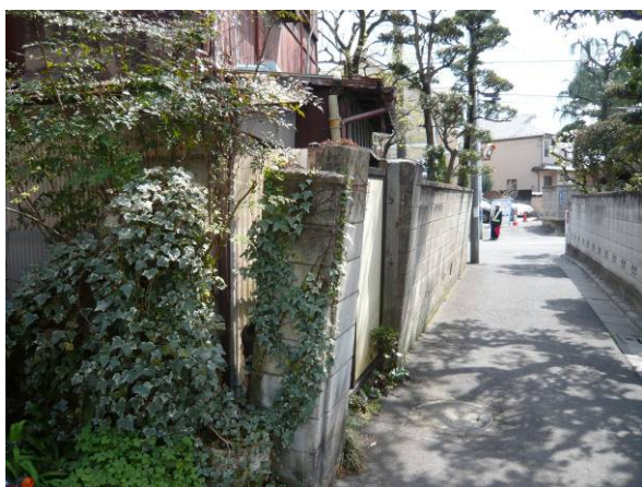
傾いたブロック塀
