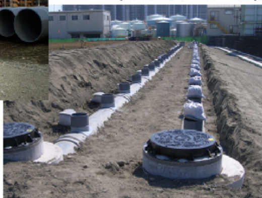
②非常用便槽 (小型マンホール)
