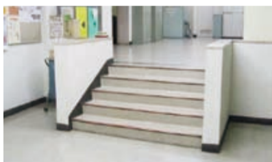
増築の際に生じた庁舎間の段差
