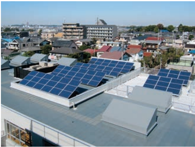
太陽光発電システム(第四中学校)
