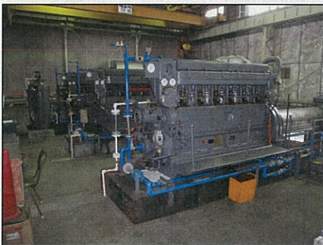
ポンプ場の老朽化した雨水排水設備
