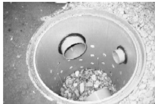
雨水浸透施設（浸透柵）
