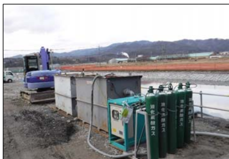
アルカリ排水中和処理設備の例
