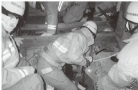
倒壊した建物の中を検索
