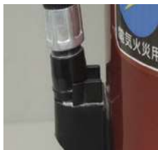
× 消火薬剤の漏れ
