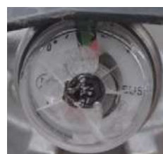
× 指示圧力計の損傷
