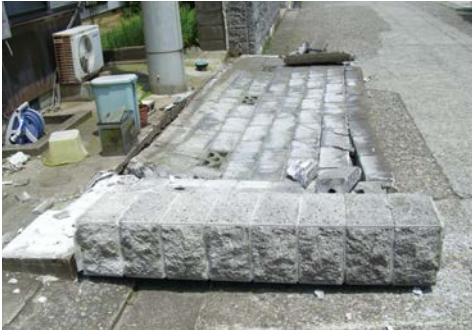
▲地震時に倒壊したブロック塀
