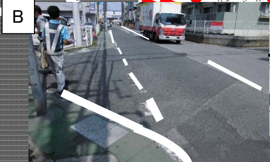
センターライン、外側線、ドット線の復旧 「止まれ」「30」路面標示の復旧
