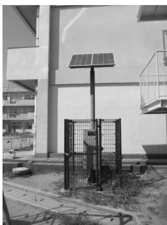
中山小学校の太陽光発電設備
