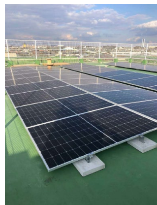
菅野小学校の太陽光発電設備
