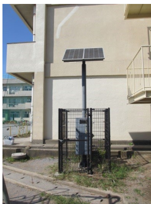
中山小学校の太陽光発電設備
