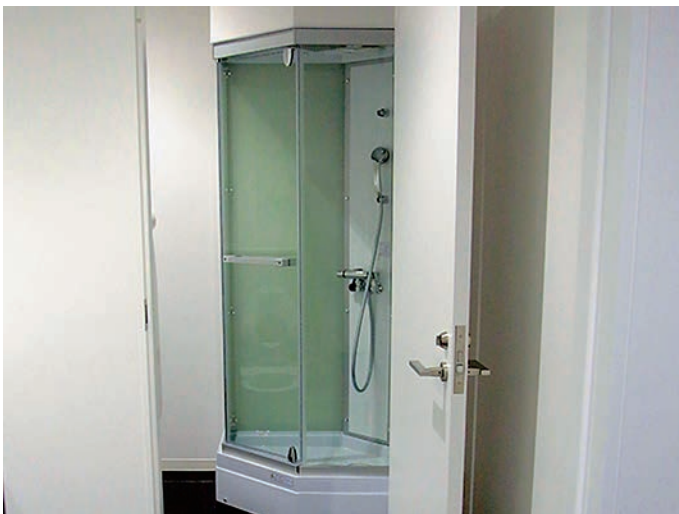
市長室に設置されたガラス張りシャワーユニット
