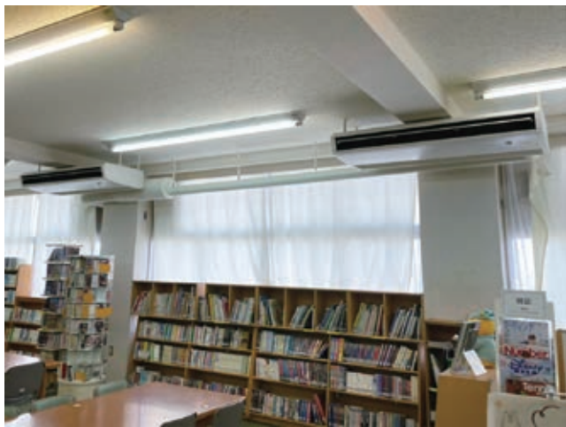
中学校の図書室に設置されたエアコン
