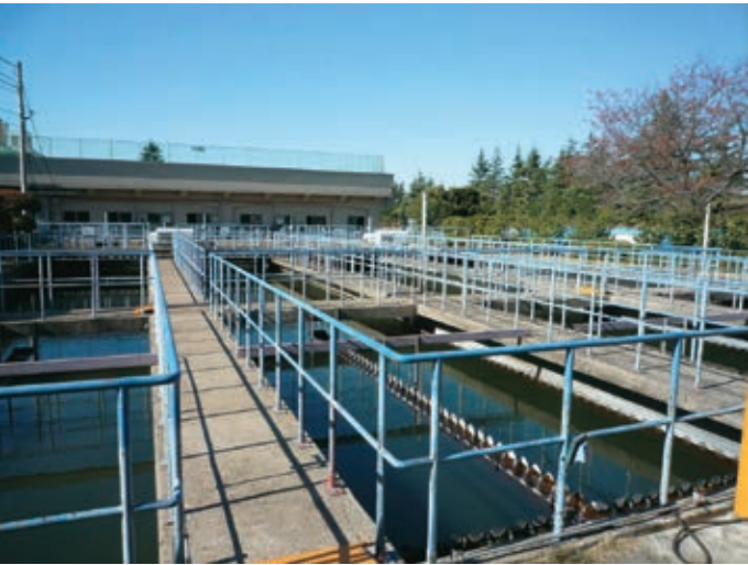
終末処理場水処理設備の一部
