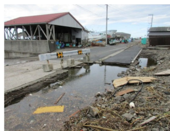
港湾施設の破損
