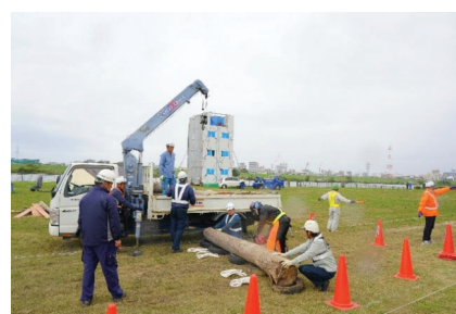
ライフライン復旧(造園業)
