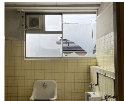
勤労福祉センター分館内のトイレの窓ガラス破損
