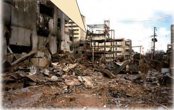
外壁の剥離・落下
