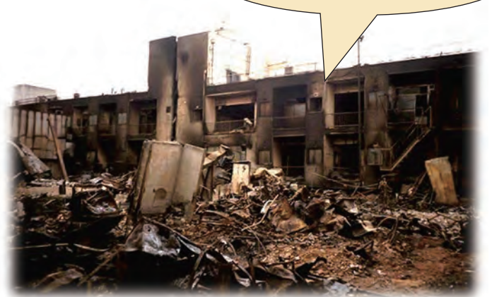
火災による被害
