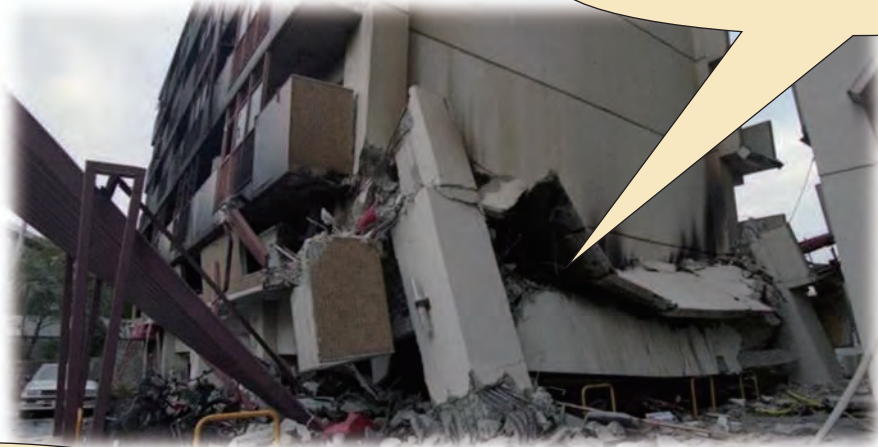
マンション2階部分の座屈
