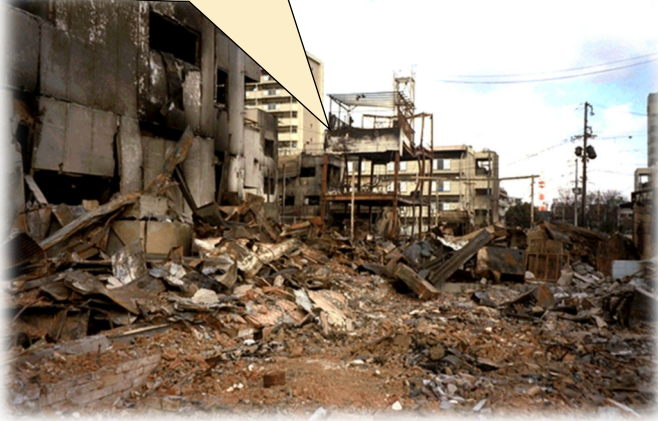
外壁の剥離・落下
