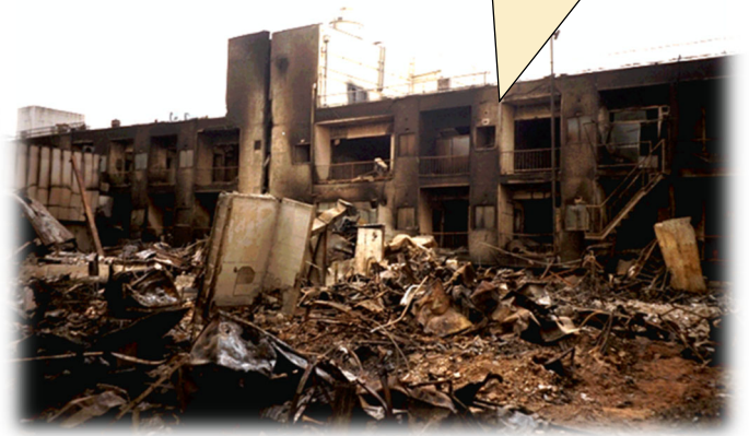
火災による被害
