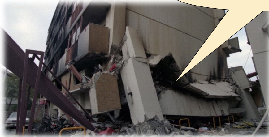
マンション2階部分の座屈
