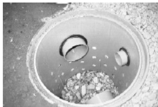
雨水浸透施設（浸透枳）
