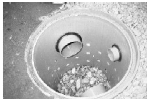
雨水浸透施設（浸透枳）
