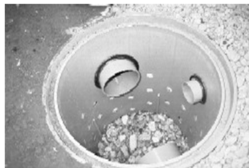
雨水浸透施設（浸透樹）
