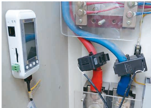
△塩焼小学校屋外照明の配電盤での電力計測
