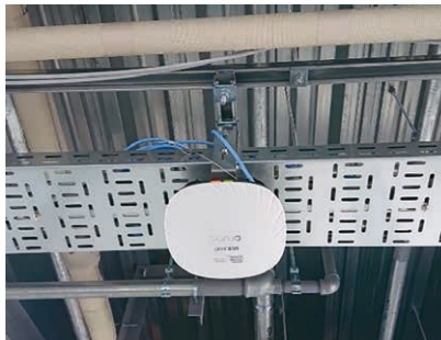
△アクセスポイント設置状況（第1庁舎1階）
