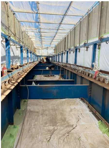
△施工中（主桁の腐食）
