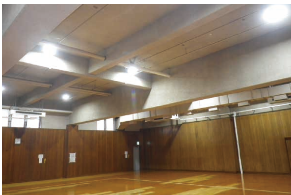
△市川市国府台市民体育館柔道場・剣道場高天井照明器具修繕後
