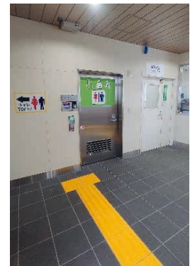
車いす対応トイレ
