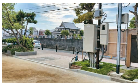
△マンホールポンプ
