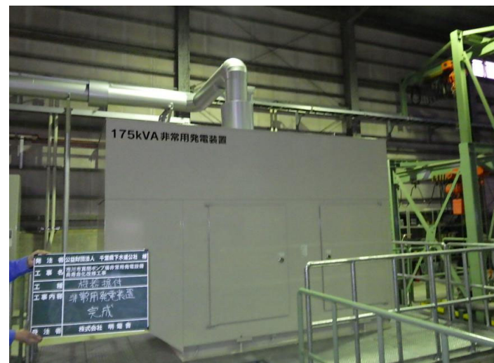
市川市真間ポンプ場非常用発電設備 長寿命化改修工事（完成写真）
