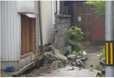
▲地震で倒壊したブロック塀
