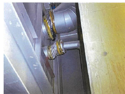
管寄せエキスパンションの破損
