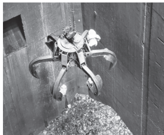
▲ごみクレーン
