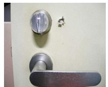
〈サムターン回しをされた扉〉
