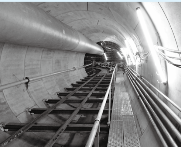
▲平成29年度に供用開始予定の下水道(雨水/市川南7号幹線)
