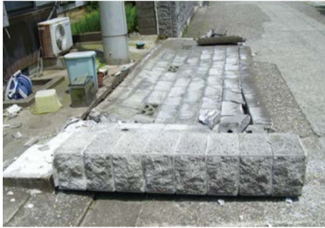
▲地震時に倒壊したブロック塀
