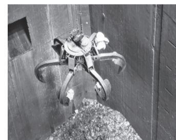
▲ごみクレーン
