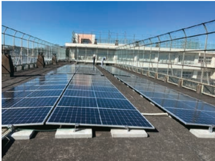
大野小学校の屋上に設置されている太陽光パネル
