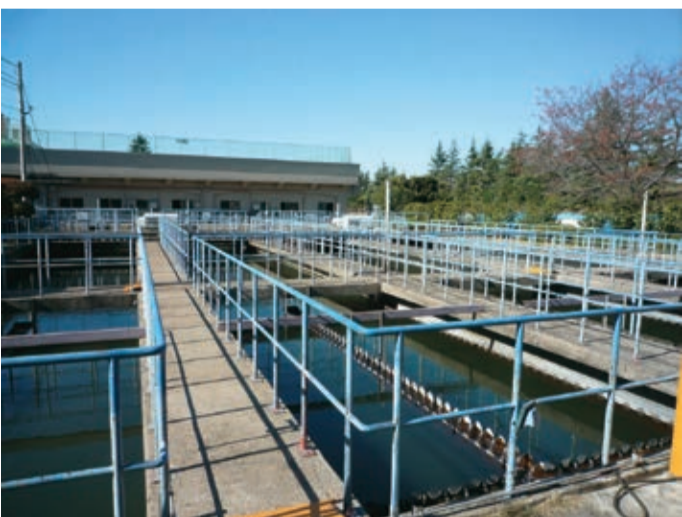
終末処理場水処理設備の一部
