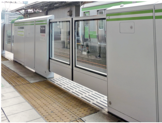
鉄道駅に設置されるホームドア
